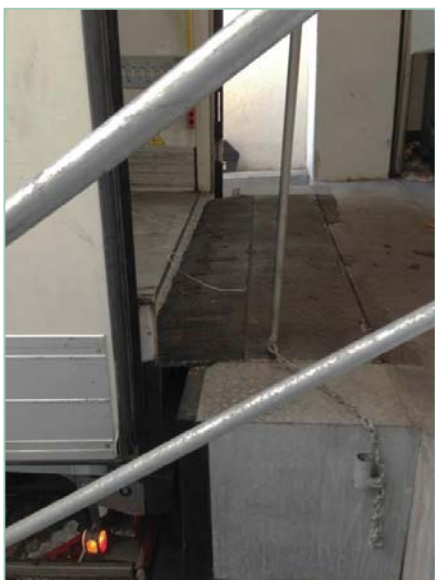
FIGUR 3. LASTVOGNE ER BAKKET IND FRA VENSTRE, HVORPÅ EN KØREPLADE MONTERET PÅ LÆSSERAMPEN TIL HØJRE KLAPPER NED I VOGNBUNDEN, HVILKET KAN GIVE ANLEDNING TIL STØJ.
